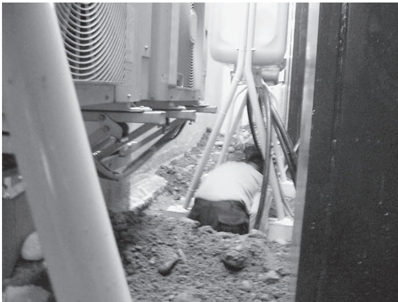
図5 事例1の作業場面 灯油タンク下に穴を掘ったところに排水管を埋設 タンクの足場がむき出しになっている。
