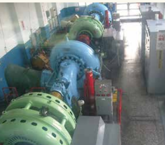
写真1B / 后里発電所の発電機
