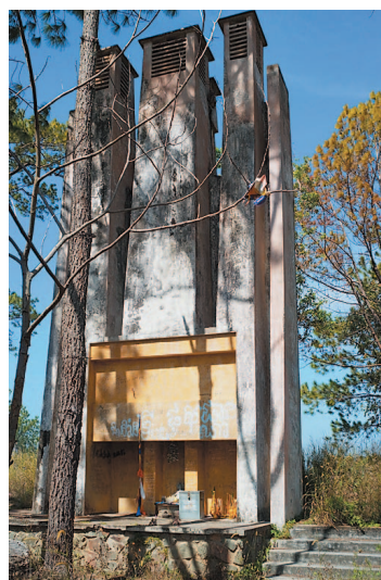
写真4 Kirirom山頂のChalet d'Etat（国家シャレー）の煙突遺構。Kiriromにとって最も重要な建築物であったが、1970年に破壊され、現在では暖炉とその上部の煙突部分および地下室だけが残されている。
